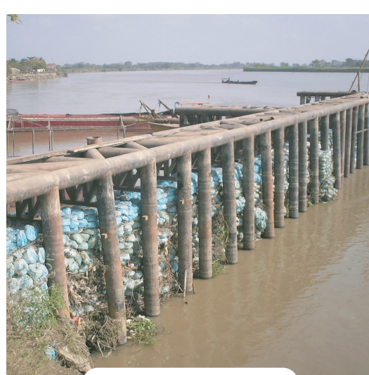
Hidrología, Hidráulica y Socavación Interventoría obras de protección emergencia río Cauca. La Mojana. Achí barrio Zarabanda
